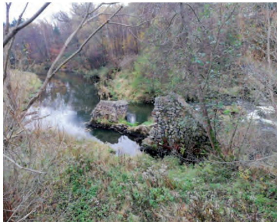
Fot. 2. Stan jazu na Kwisie w miejscowości Ławszowa w październiku 2021. Widok pozostałości jazu w korycie rzeki od strony górnej wody (autor Mirosław Ryś)
