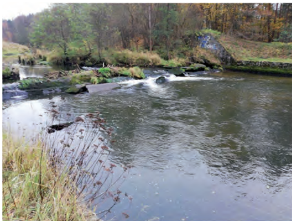
Fot. 1. Stan jazu na Kwisie w miejscowości Ławszowa w październiku 2021. Widok pozostałości jazu w korycie rzeki od strony dolnej wody (autor Mirosław Ryś)
